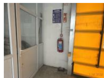
Fire extinguisher posted.JPG
